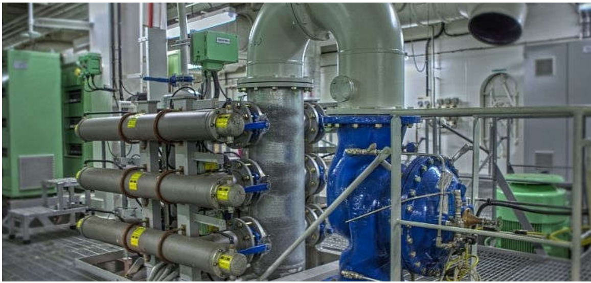
Şekil 20: Üç adet UV bölmeli Optimarin Balast Suyu Arıtım Sistemi
